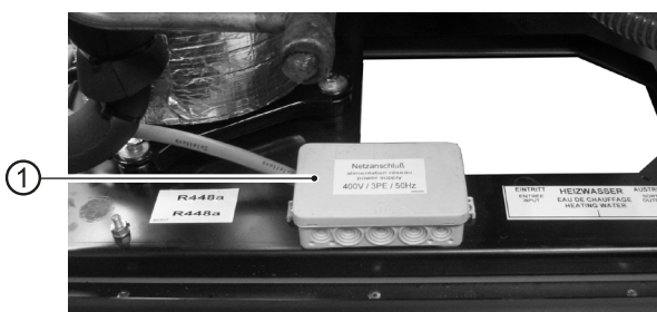
1 Elektrische Anschlussdose: Netzanschluß Wärmepumpe
